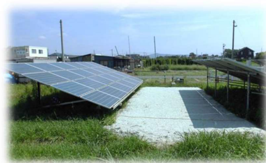
太陽光発電所での防草・反射材
