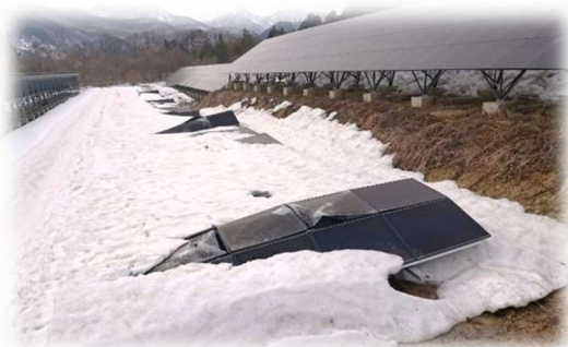
太陽光パネルの廃棄・破損
